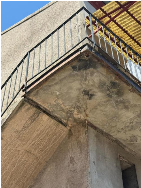
Sous-face : fissuration, altérations et traces liées aux entrées d'eau.
