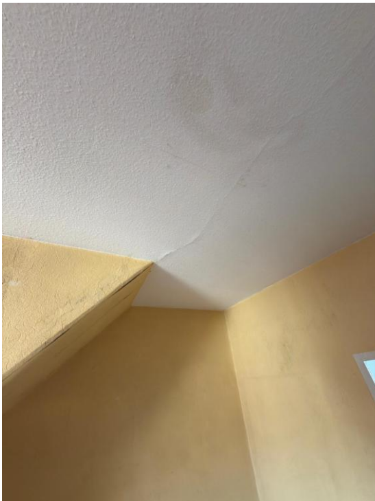
Vue localisée d'un plafond. La souplesse ressentie lors de la circulation ne peut pas être restituée par une photographie.
