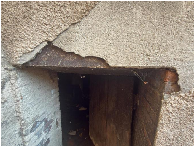
Corrosion visible en rive et au droit des assemblages.
