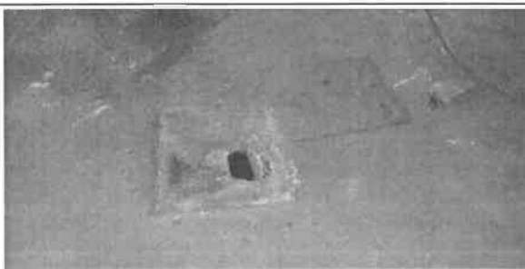
Photographie 4 : Grille d'évacuation est zone peinture
