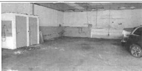
Photographie 3 : Zone peinture – côté est
