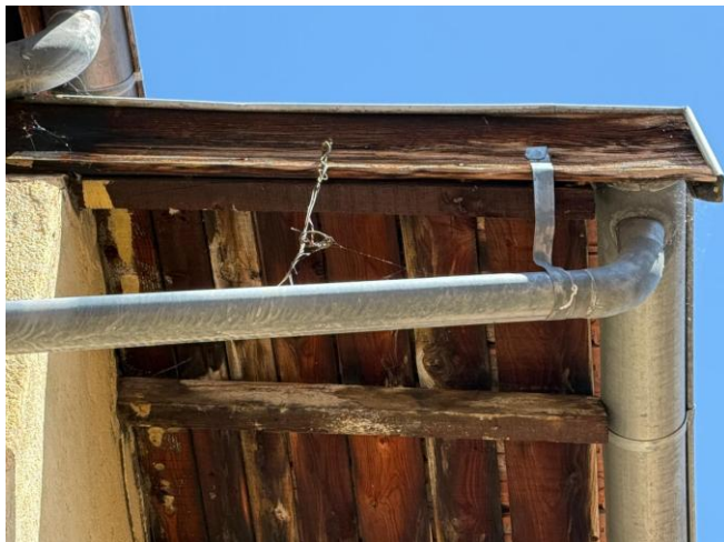
Chevrons en rive ayant subi des entrées d'eau.
