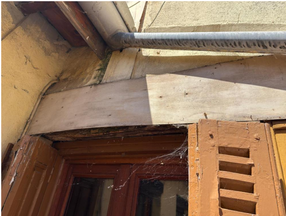
Linteau bois au-dessus de la porte-fenêtre, exposé aux entrées d'eau.
