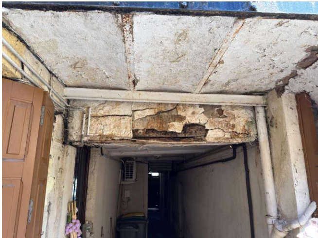
Bois fortement altéré au droit du passage.
